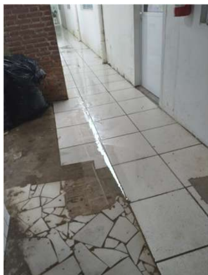
*telhado e infiltrações
